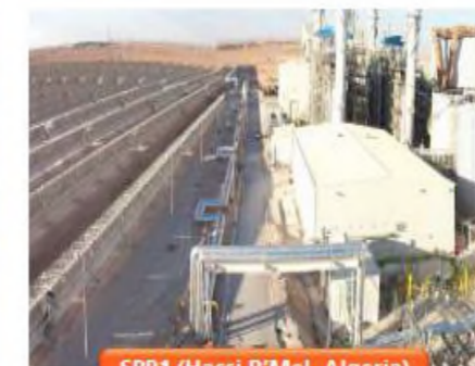
SPP1 (Hassi R'Mel, Algeria) ISCC 150 MW
